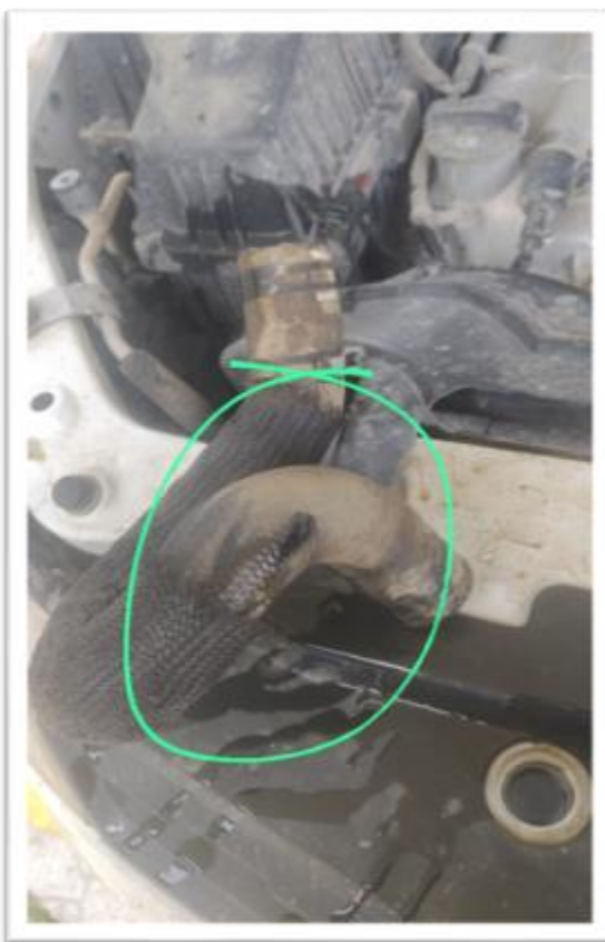
MANGUERA DE SISTEMA DE ENFRIAMIENTO DE MOTOR
