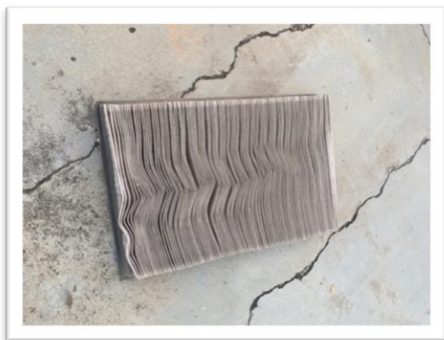
CAMBIO DE FILTRO DE AIRE
