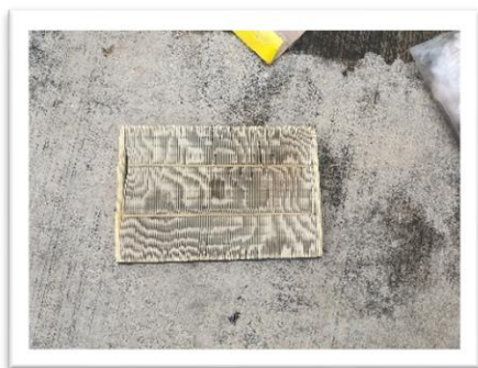
CAMBIO DE FILTRO DE AIRE
